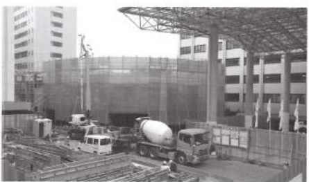
建設中の新D号館。隣接する屋根付きの中庭と連動した活動やイベントなどの開催が可能だという
