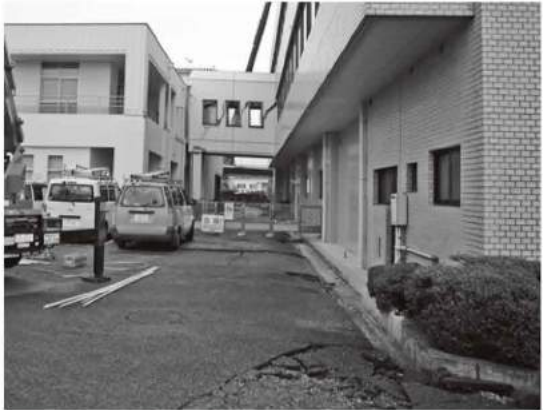
③地盤変状と渡り廊下の損傷
