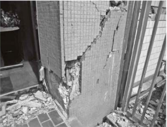
⑥1階柱のひび割れ状況
