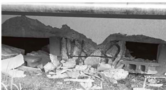
⑬基礎柱の損傷（提供：山本伸二氏（ケイシン設計））
