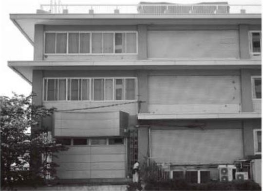
⑤増設壁と既存柱のせん断ひび割れ（提供：蛸川利彦九州大学教授）
