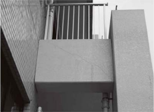
②外付けフレーム取付け梁のひび割れ
