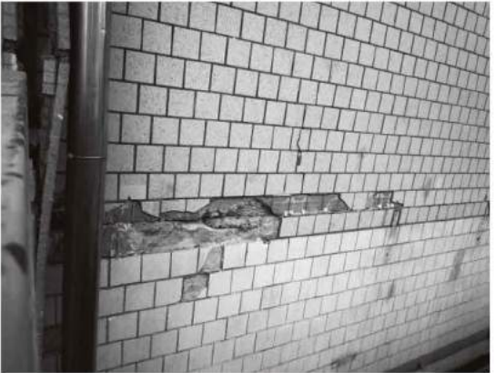
⑧写⑦の柱に隣接する増設壁のひび割れ
